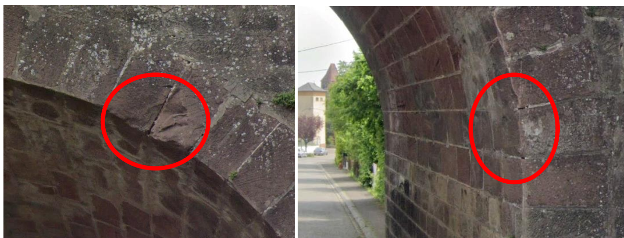
Quelques joints très légèrement dégradés
